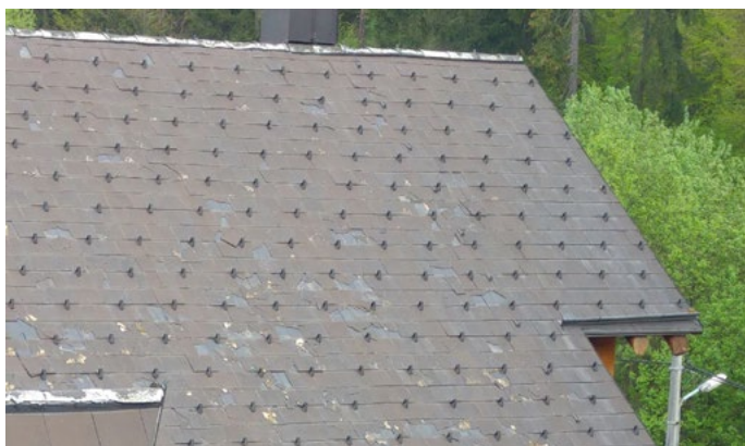
Obr. č. 2 Stav vlákno-cementovej strešnej krytiny pred rekonštrukciou
